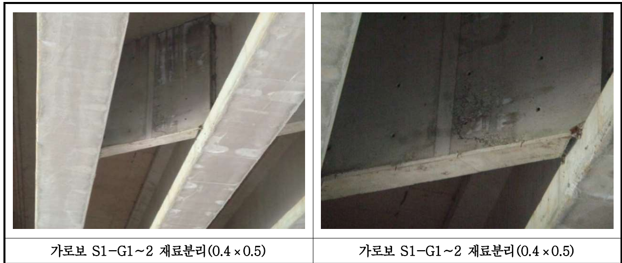
【사진 14.3.28】 가로보 손상현황
