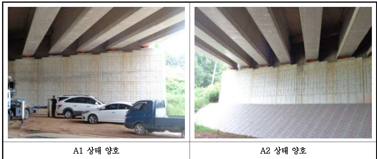
【사진 14.3.9】 교대 손상현황
